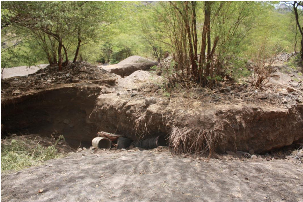
Fig. 5 - Árvores mostrando raízes danificadas pela escavação e compactação do solo Ribeira da Barca - Ilha de Santiago
