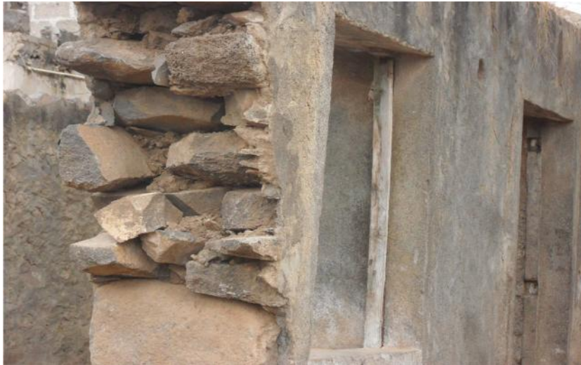
Figura. 3.2 – Ruínas de casa construída dos anos 60, feita de pedra e barro e revestida com argamassa de areia e cimento nas paredes exteriores. Arredores da Cidade de Calheta São Miguel, Ilha de Santiago.
